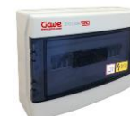
CUADRO STRING, FUSIBLES 15A, 1.000V LIMITADOR SOBRETENSIONES SECCIONADOR
